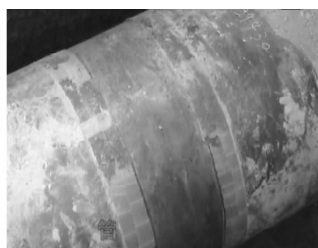
图2 环氧底漆涂装失效
