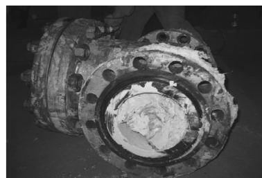
图 2 加氢装置循环氢混氢点单向阀铵盐堵塞
