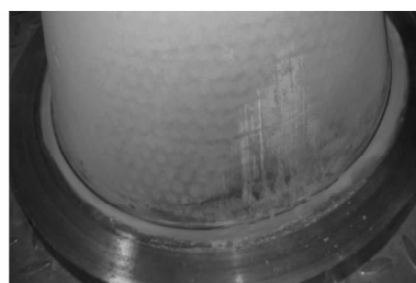
图 3 重整循环机入口过滤网铵盐堵
