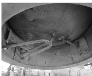
图 1 再生烧焦气干燥器入口分液罐底部氯腐蚀
