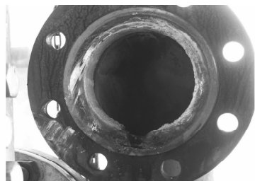
图4 液化气空冷南侧法兰面
