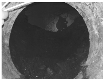
图3 大检修时高温热水器内的渣 (已于人孔平齐)
