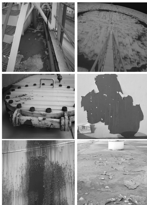
图 1 部分油罐腐蚀图片
