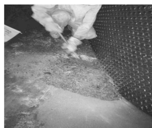
图 3 废热锅炉聚合物
