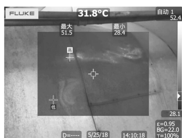
图 5 R201 出口普通保温段管道红外热像仪照片
