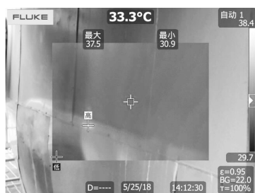
图 4 R201 出口稀土保温段管道红外热像仪照片
