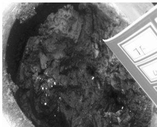
图2 激冷水泵及激冷水管线的堵塞情况
