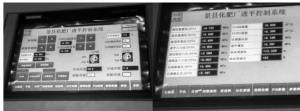
图8 现场运行监控画面
