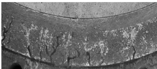
图3 法兰密封面腐蚀情况
